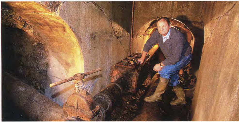
Roger Jouan, dans l'un des conduits souterrains de la Grande cascade : “Un fontainier passe une grande partie de ses journées sous terre et dans l'eau, mieux vaut ne pas être claustrophobe !”
